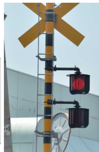
【全方向踏切警報灯】
