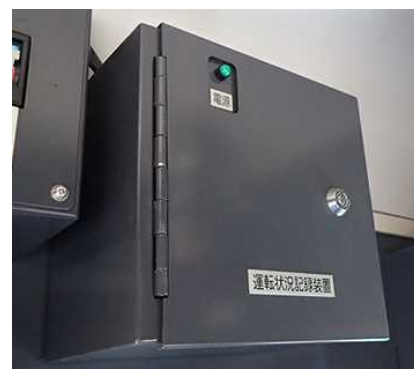
【運転状況記録装置】
