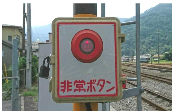
【踏切支障報知装置（非常ボタン）】
