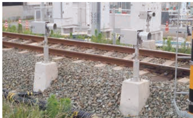
踏切障害物検知装置
