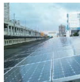
太陽光パネル(宇多津駅)
